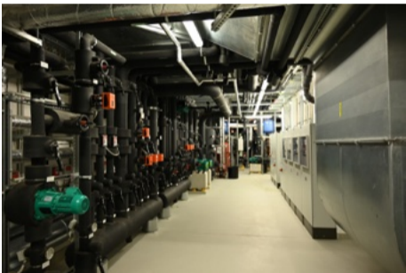
Abbildung 27: Blick in die Technikzentrale
